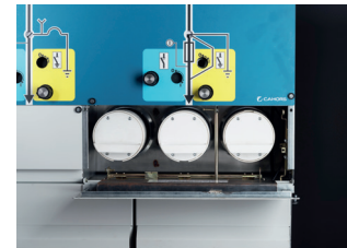
3 puits fusibles sur IFA
