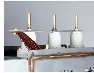
Prises d'injection de tension sur AI
