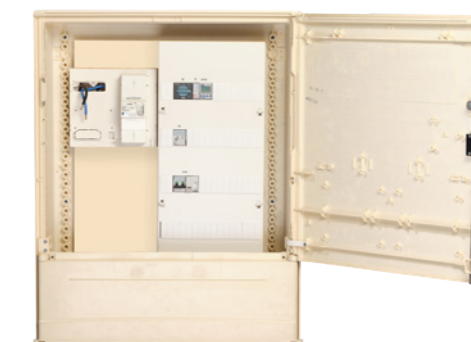
Exemple de borne équipée
