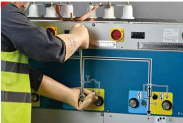
Manœuvre d'un interrupteur
