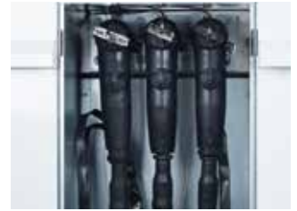
Raccordement MT, sur cellule Arrivée Interrupteur (AI)
