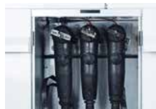
Raccordement MT sur cellule Arrivée Interrupteur
