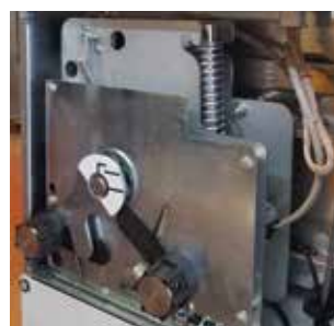
Mécanisme commande Tumbler motorisé sur cellules AI
