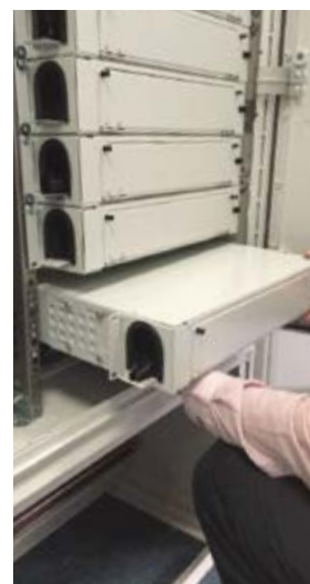
Armoire équipée pour Fibre Optique
