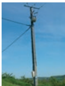
Poste de transformation : Transformateur TPC avec protection surcharge intégrée et tableau BT Trafix
