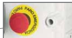
Paro de emergencia
