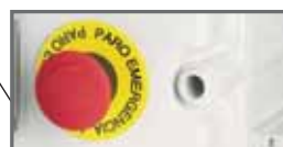
Paro de emergencia
