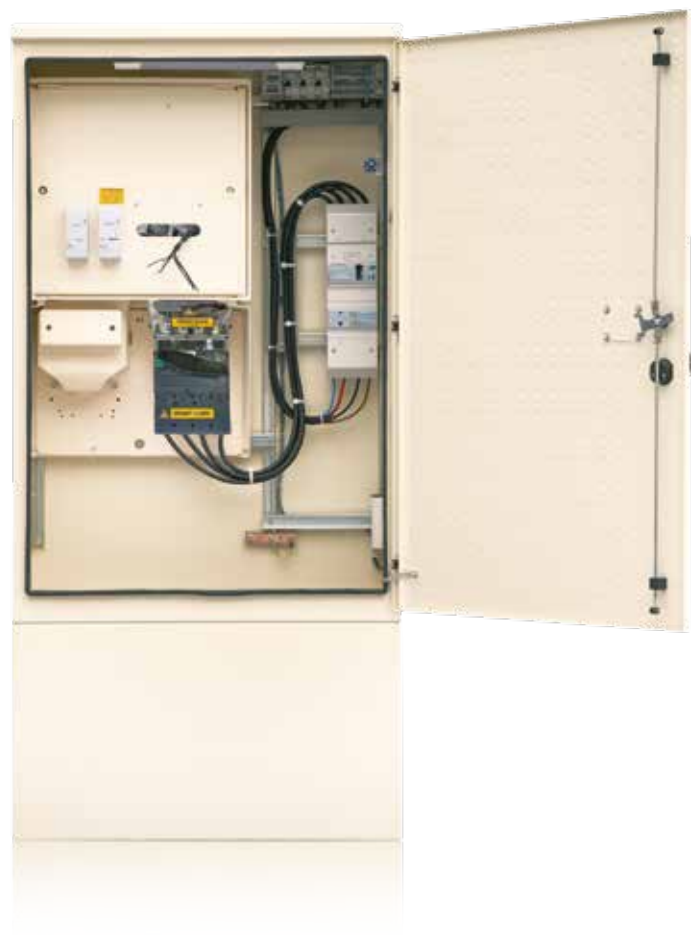
Exemple d'armoire équipée
