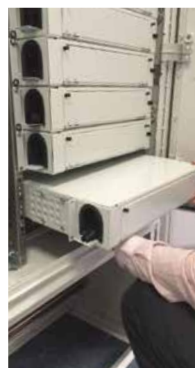
Armoire équipée pour Fibre Optique
