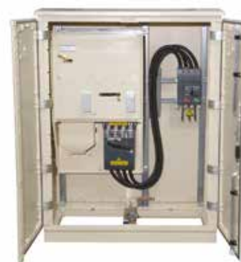
Armoire équipée BPS + Disjoncteur
