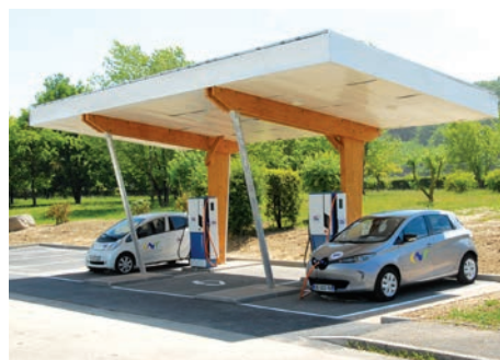
CORRI-DOOR ELECTRIQUE : VALLÉE DU RHÔNE Déploiement de stations composées de 2 bornes de charges rapides
