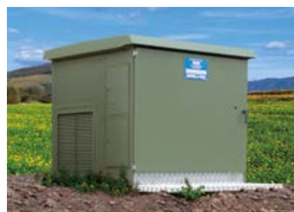
Exemple de poste au sol
