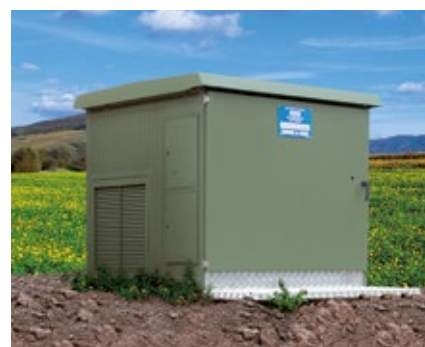
Exemple de poste au sol
