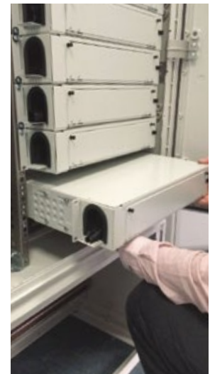
Armoire équipée pour Fibre Optique
