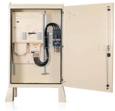
Armoire de chantier équipée Réf. 0710202R13 Equipée d'un coffret BPS Type 2 équipé de fusibles HPC 200 A et d'un disjoncteur différentiel NFX 2.2AB 250 A
