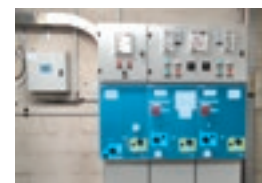
Poste satellite de la boucle
