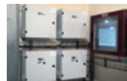
Local alimentations secourues et reconfigurateur
